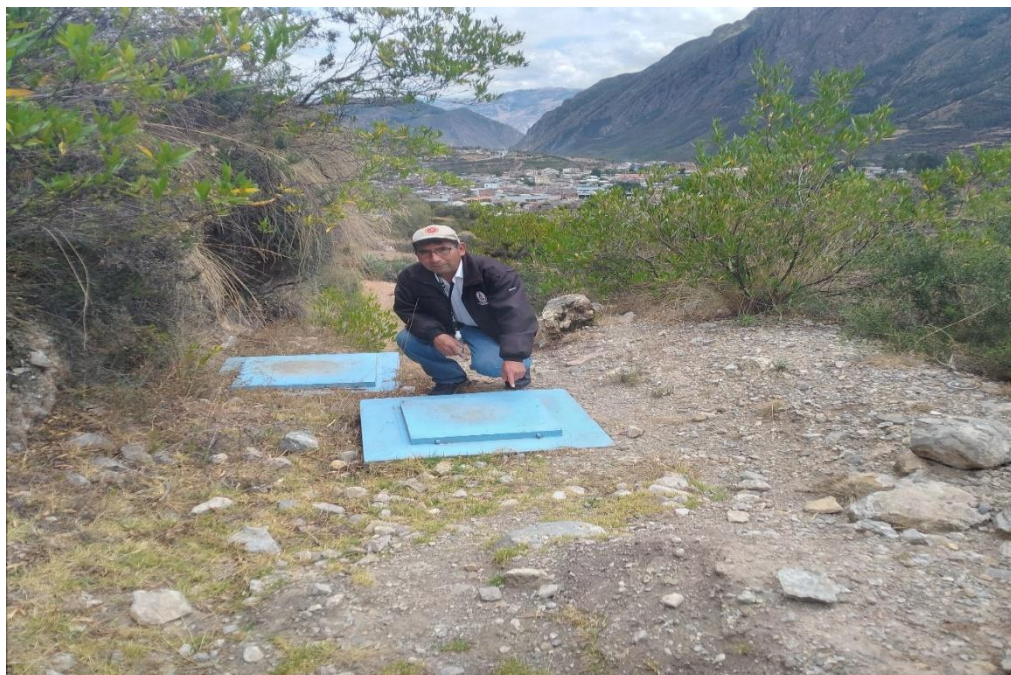
Fotografía N° 05 valvula de aire
