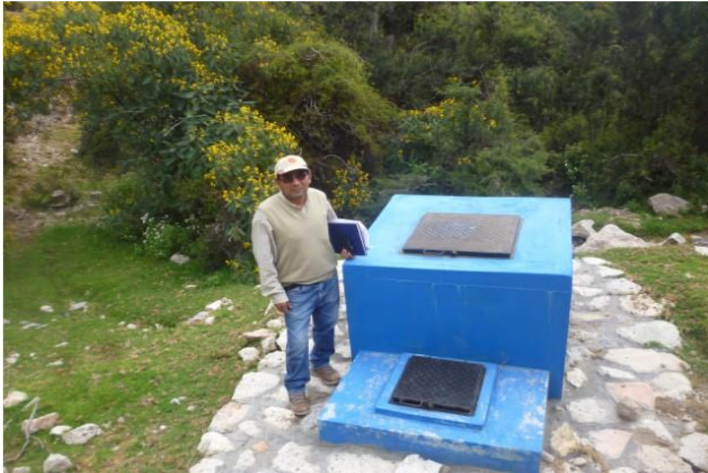
Fotografía N° 04 Camara rompe presión tipo VI
