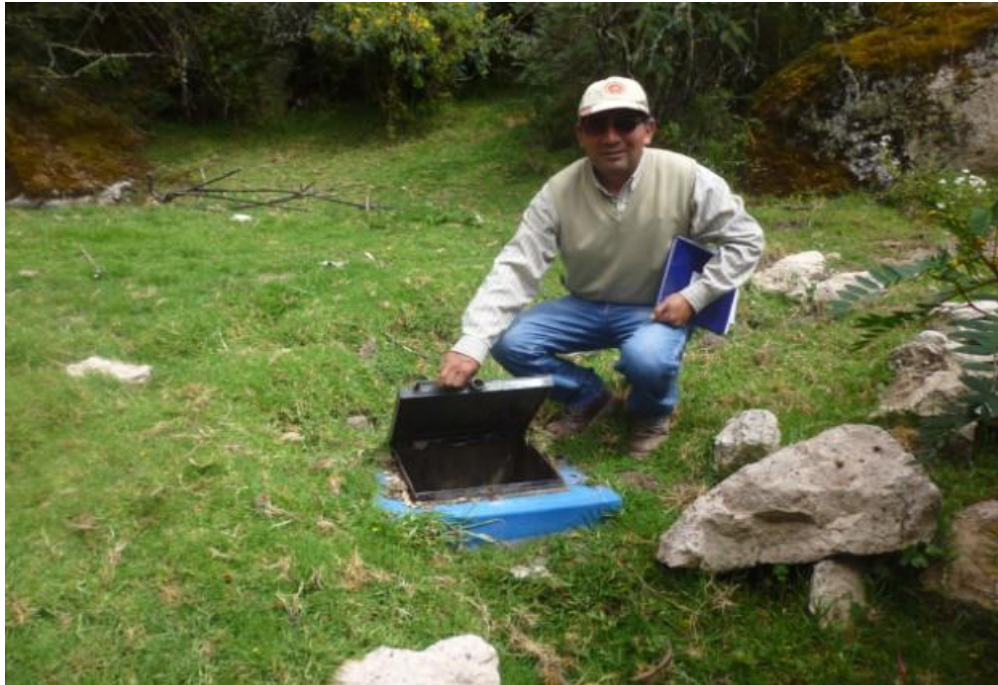
Fotografía N° 06 valvula de aire
