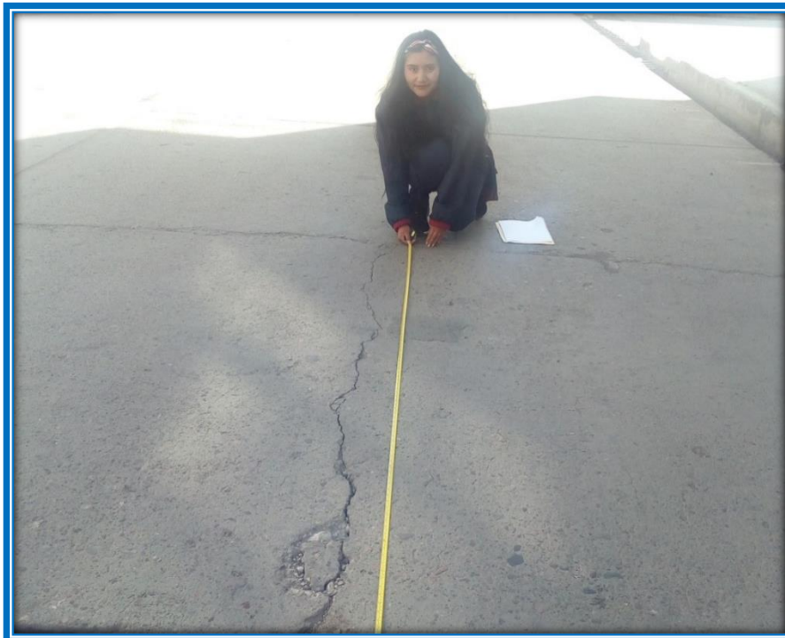
Figura 16: Se muestran grieta lineal
