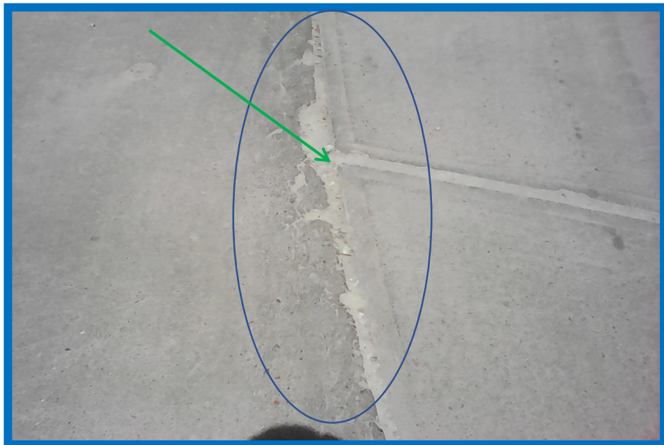
Figura 13: Se observa la existencia de la patología descascamiento de juntas
