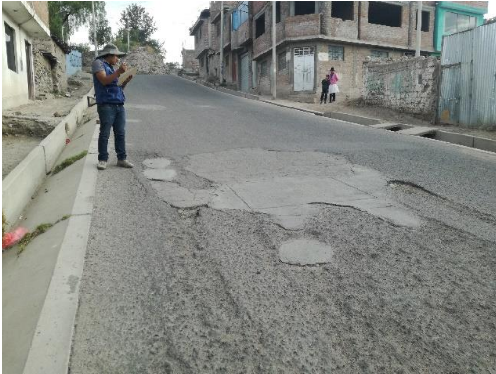
Foto 1 : Parches que se encuentra en la vía en la progresiva 0+240 (Fuente propia)
