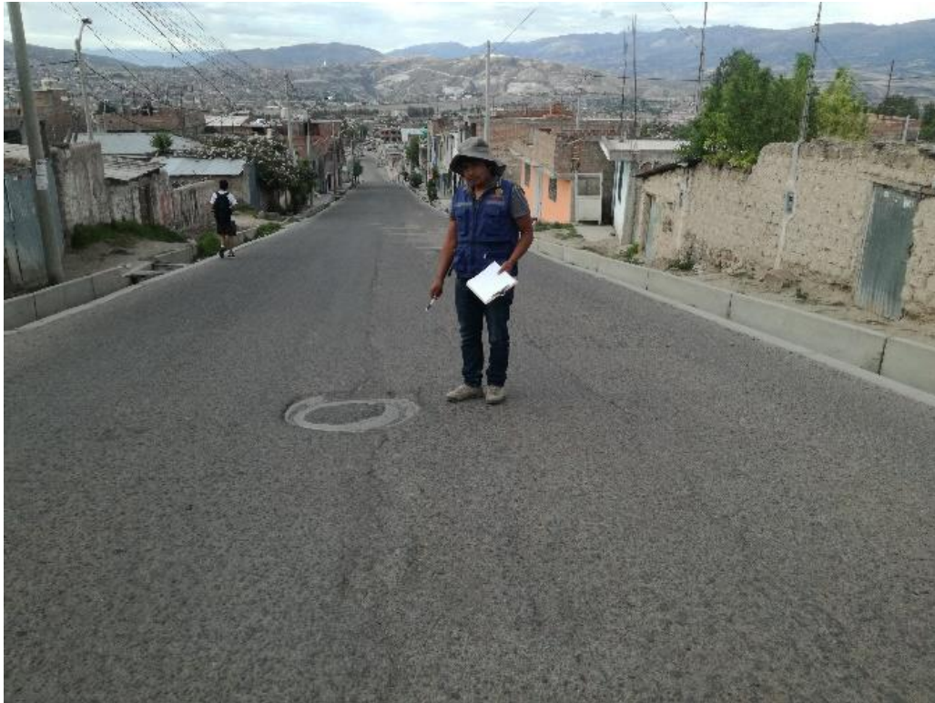
Foto 2: Grieta Longitudinal en la 0+220 (Fuente propia)
