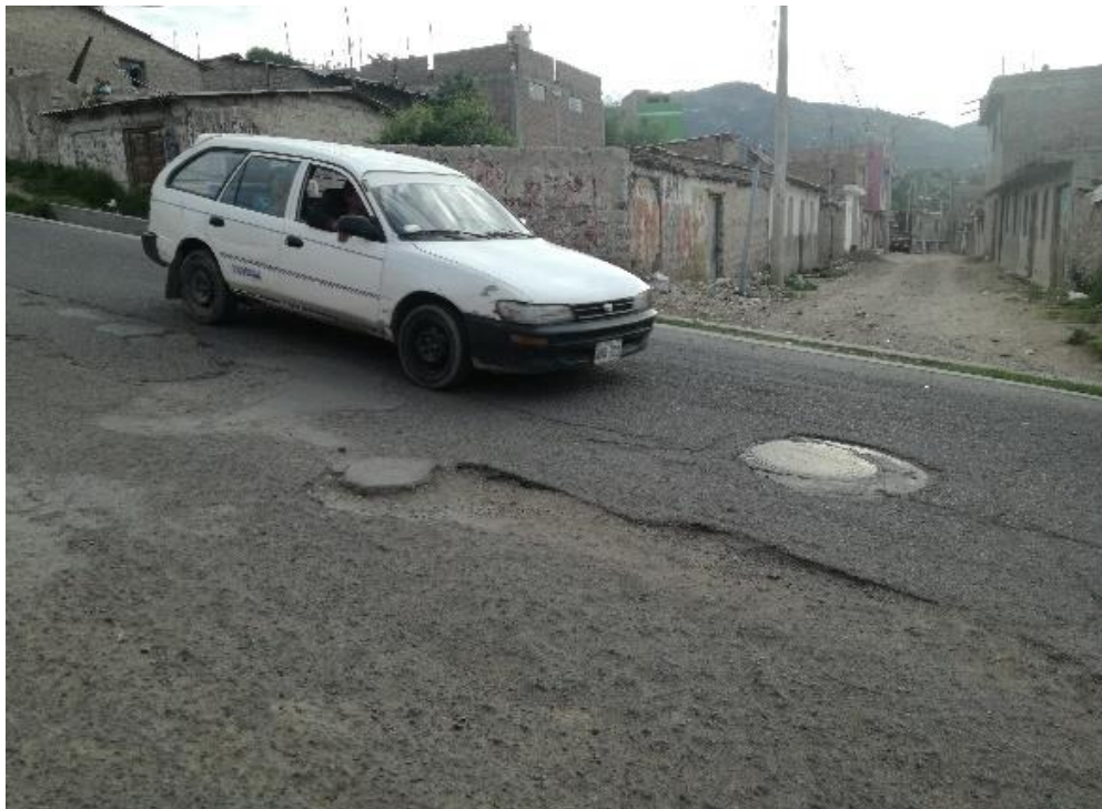
Foto 3: Huecos en la progresiva 0+460 (Fuente propia)
