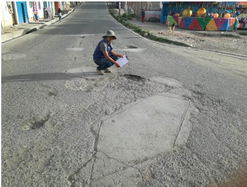
Foto 4: Huecos y parches en la progresiva 0+100 (Fuente propia)
