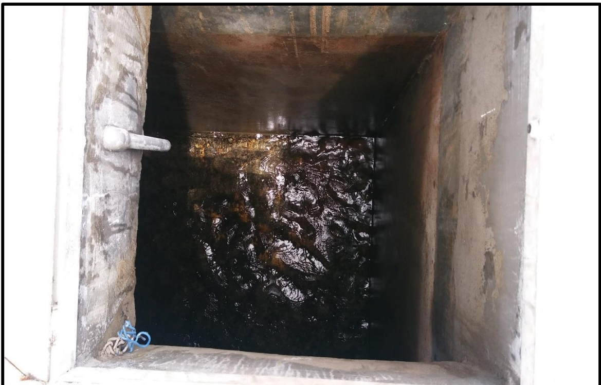
Fotografía N° 5 Se muestra la grava del concreto en el piso del reservorio existente
