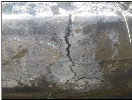
Figura 50: Fotografía de la patología Grieta. Fuente: Elaboración propia, 2021.
