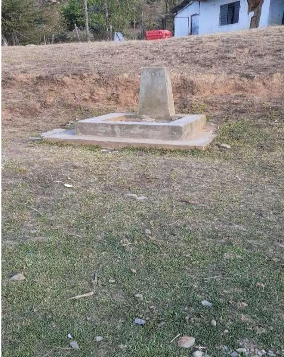
Fotografía N° 3: pileta pública en mal estado y sin servicio
