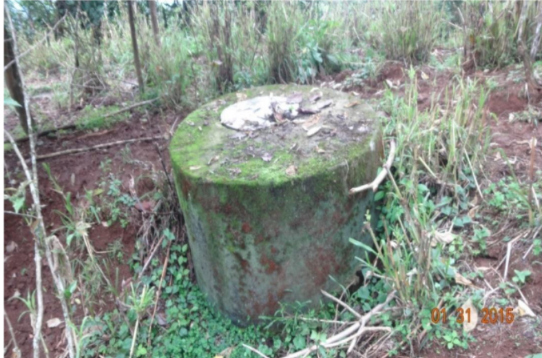
Fotografia N°1 BUZONES EN MAL ESTADO
