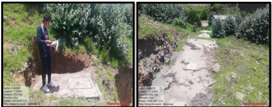
Imagen 12: Cámara de Rejas.
