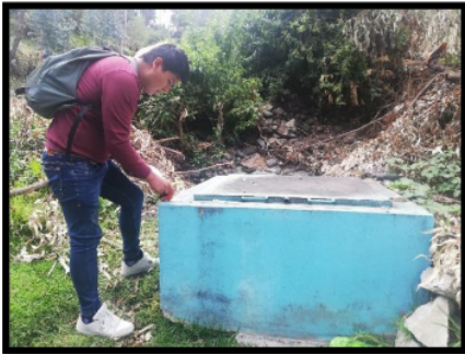
Imagen 01: Captación de agua CAP-01
