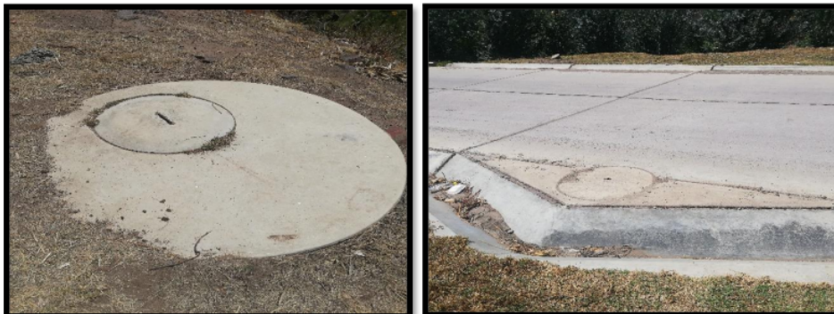
Imagen 10: Buzones de desagüe.
