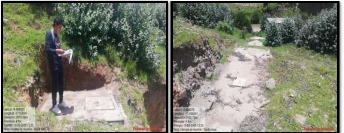
Imagen 12: Cámara de Rejas.
