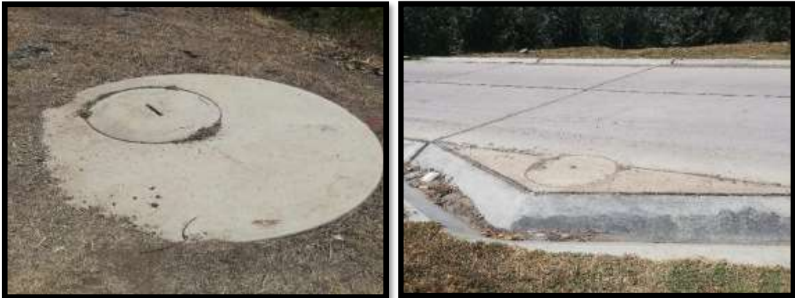
Imagen 10: Buzones de desagüe.
