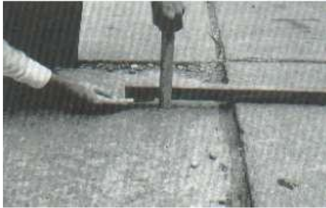
Figura 19. Grieta de esquina.
