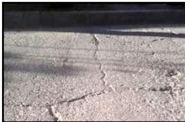
Figura 7. Fisura longitudinal. Fuente: elaboración propia.
