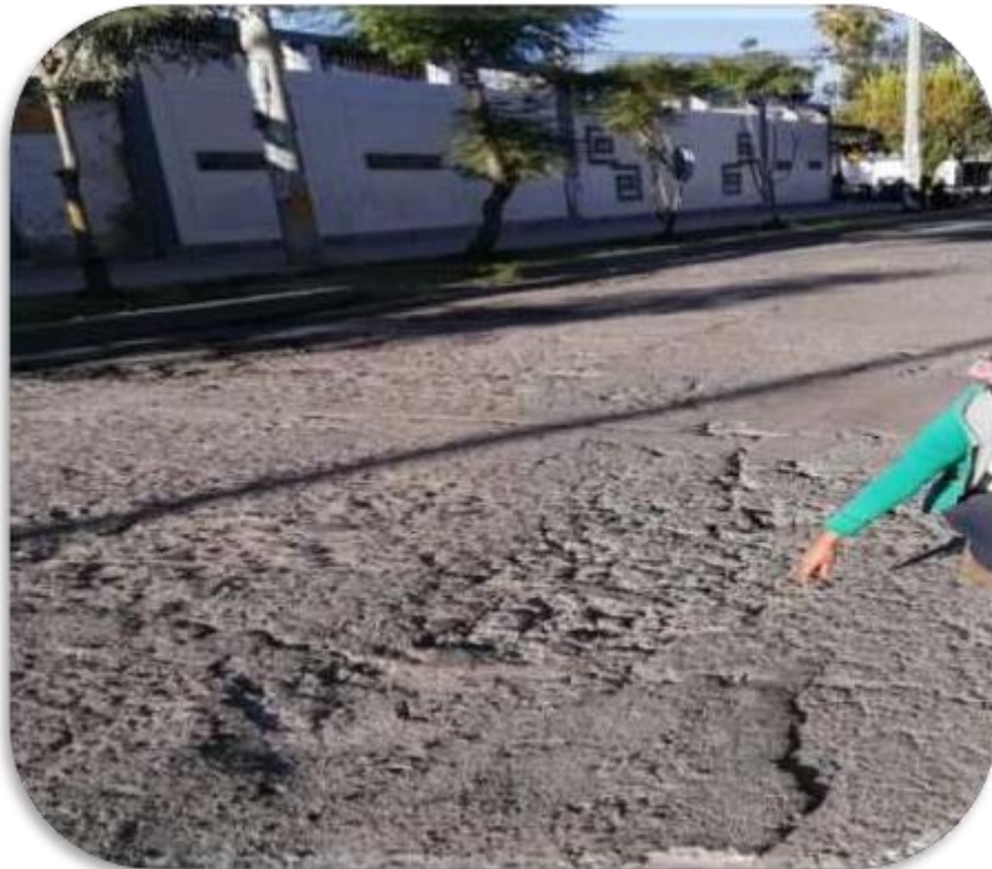
FOTOGRAFIA 3 Bache (cavidad de bordes irregulares)
