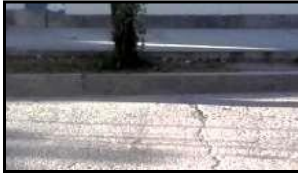
Figura 6. Fisura transversal Fuente: elaboración propia.
