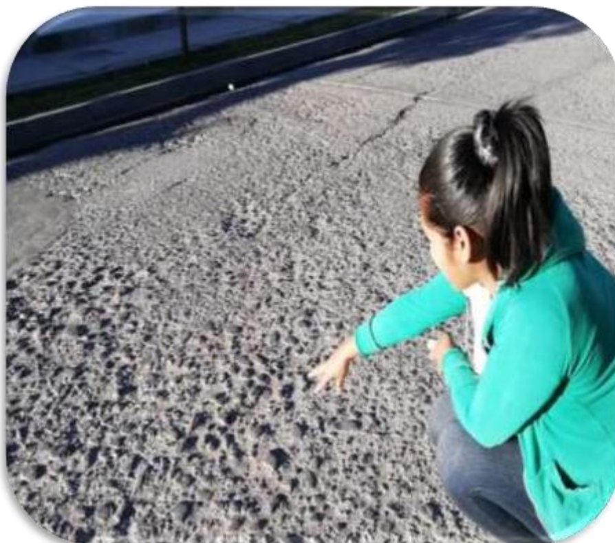
FOTOGRAFIA 2 Observaciones de los daños del pavimento en la Av. Universitaria.
