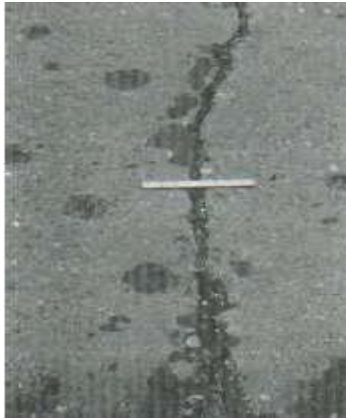
Figura 16. Grieta lineal. Fuente: Manual de pavement condition índex (PCI)
