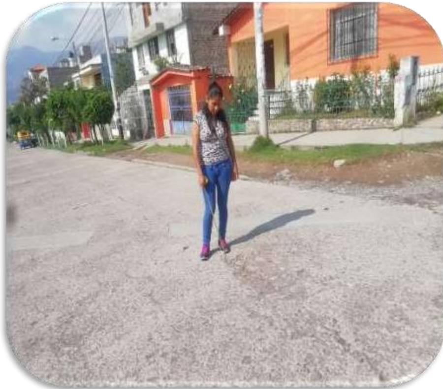
FOTOGRAFIA 5 Fisuramiento debido a cargas en la UM-02.
