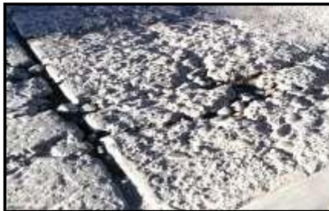
Figura 8. Fisura en la esquina del paño. Fuente: elaboración propia.
