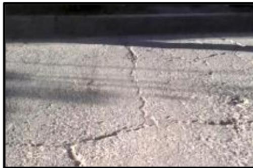
Figura 7. Fisura longitudinal. Fuente: elaboración propia.
