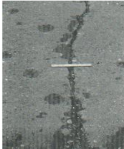
Figura 16. Grieta lineal. Fuente: Manual de pavement condition índice (PCI)
