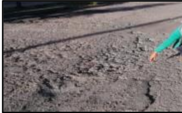
Figura 13. Bache (cavidad de bordes irregulares). Fuente: elaboración propia.
