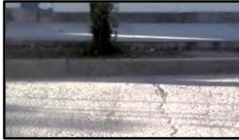
Figura 6. Fisura transversal Fuente: elaboración propia.
