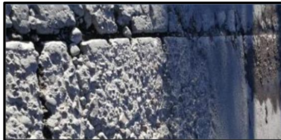
Figura 14. Deficiencia de material de sello. Fuente: elaboración propia.
