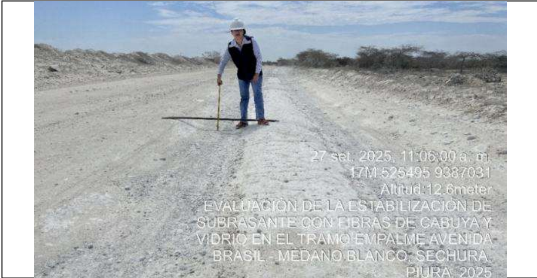
FOTO 05: La imagen muestra un tramo de la vía erosionado.
