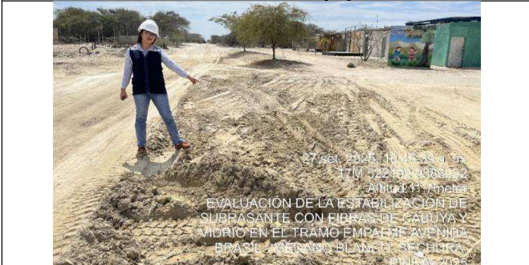
FOTO 07: La fotografía muestra un tramo con evidentes fallas de erosión y deterioro superficial.
