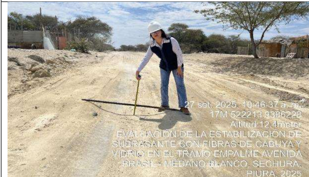
FOTO 02: La imagen muestra la presencia de un bache o deformación localizada en la superficie de la carretera, evidenciada por hundimientos y pérdida de material granular.
