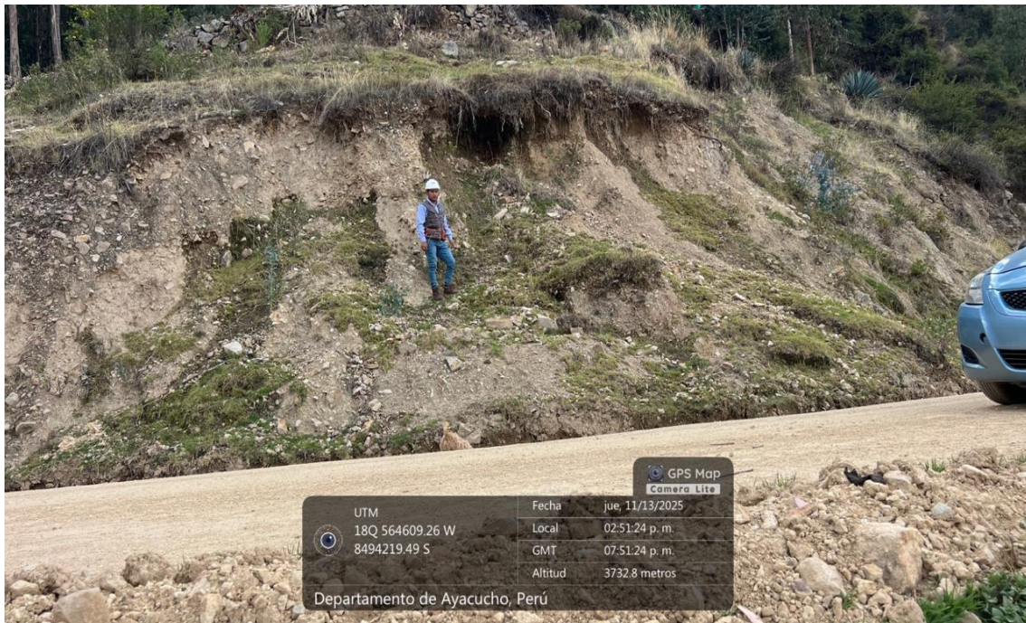
Talud con signos de inestabilidad a lado de la carretera
