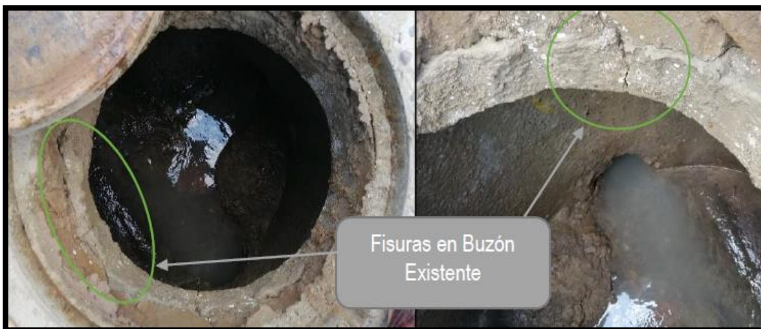
Fotografía 10: Buzones con fallas estructurales.
