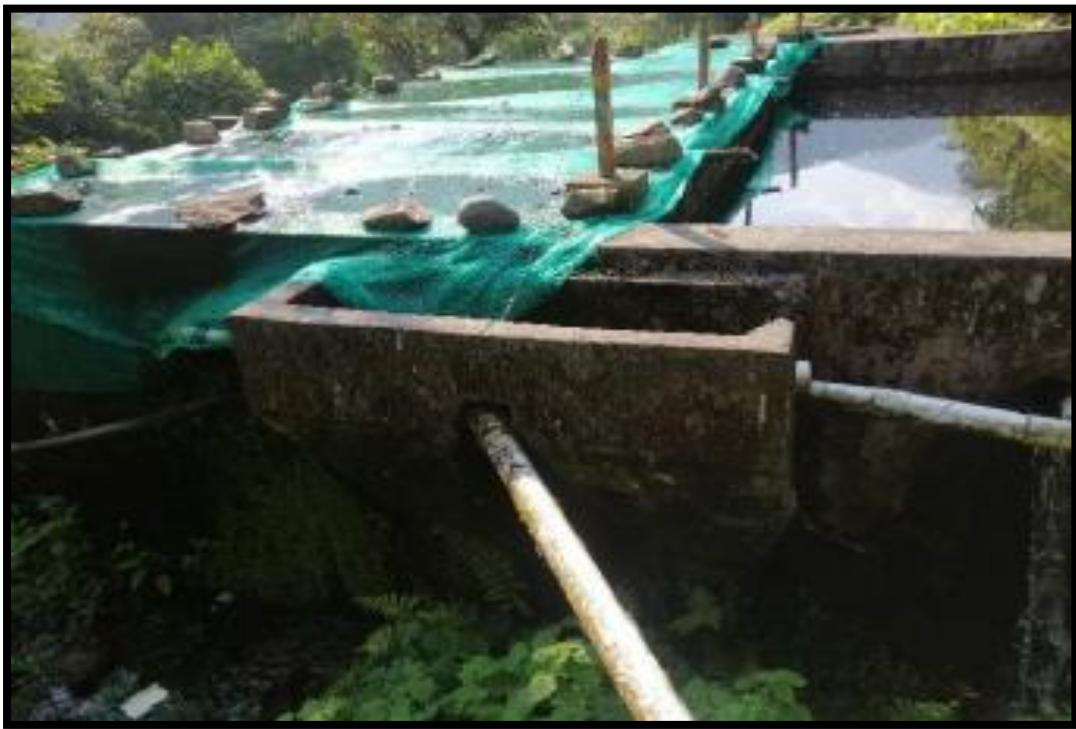
Fotografía 5: Filtro lento deteriorado.
