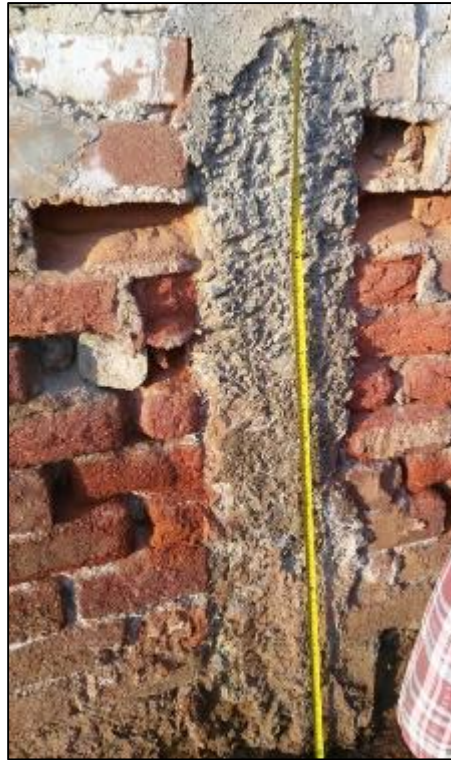
Figura 14: Desprendimiento en muros del cerco perimétrico del Almacén Pesquero.
