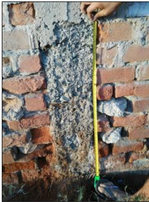
Figura 12: Desintegración en muros del cerco perimétrico del Almacén Pesquero.
