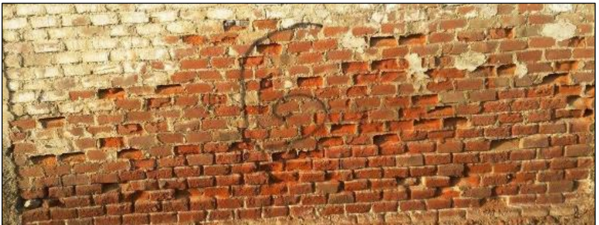
Figura 15: Filtración en muros del cerco perimétrico del Almacén Pesquero.
