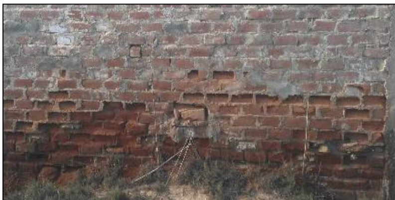
Figura 6: Erosión física en cerco perimétrico.
