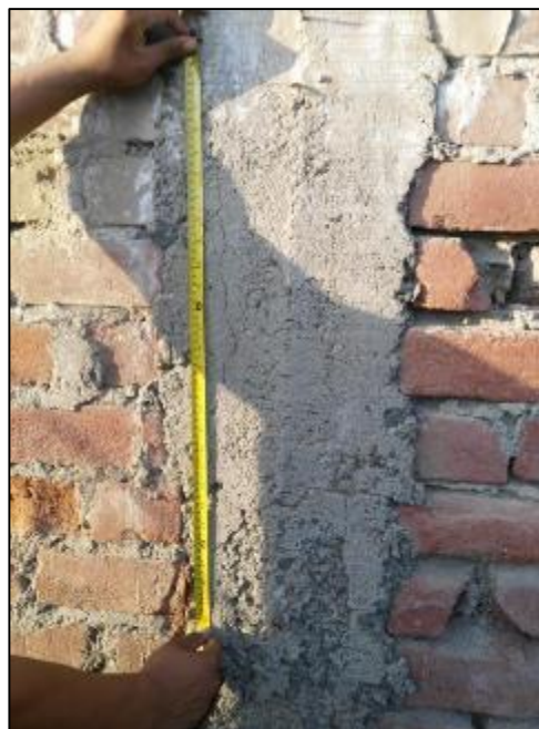
Figura 13: Fisura en columnas del cerco perimétrico del Almacén Pesquero.
