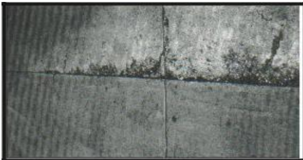
Figura 17. Descripción de descascaramiento de Junta.
