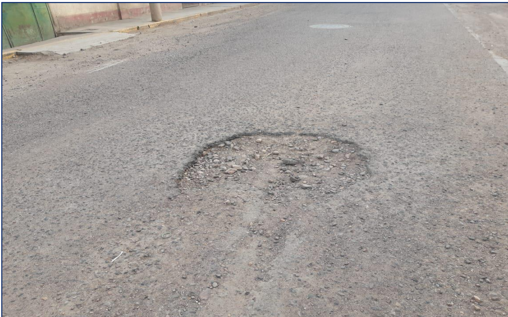
Fotografía N° 08: patología huecos, severidad media Fuente: Elaboración propia.
