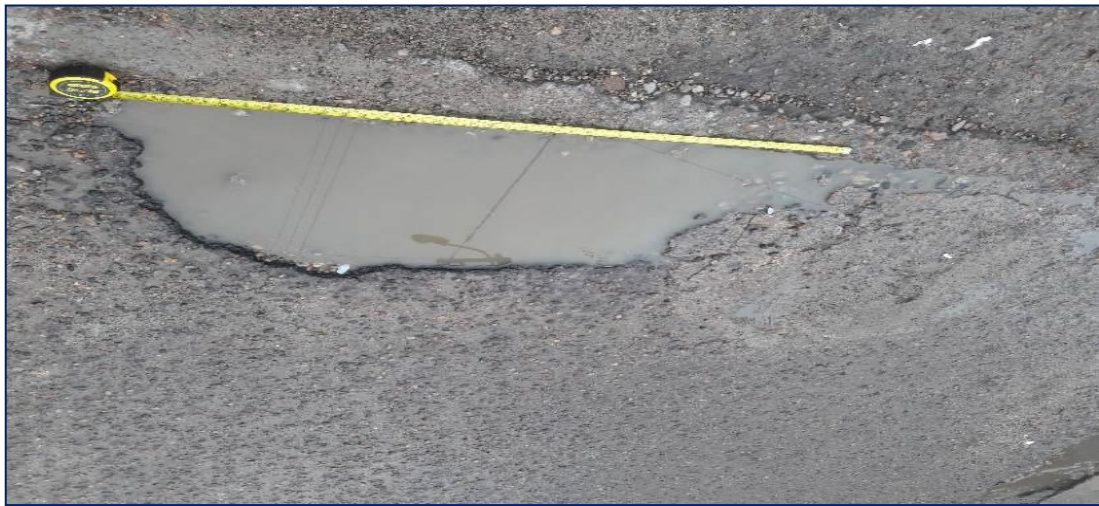
Fotografía N° 02: patología hallada huecos, nivel de severidad alto. Fuente: Elaboración propia.
