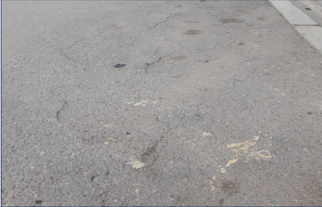
Fotografía N° 07: patología corrugaciones, severidad alta Fuente: Elaboración propia.
