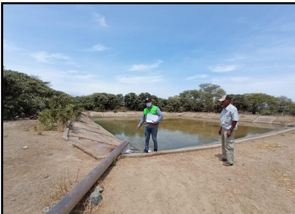
Imagen 9. Sistema de conducción, con tubería metálica de 6''
