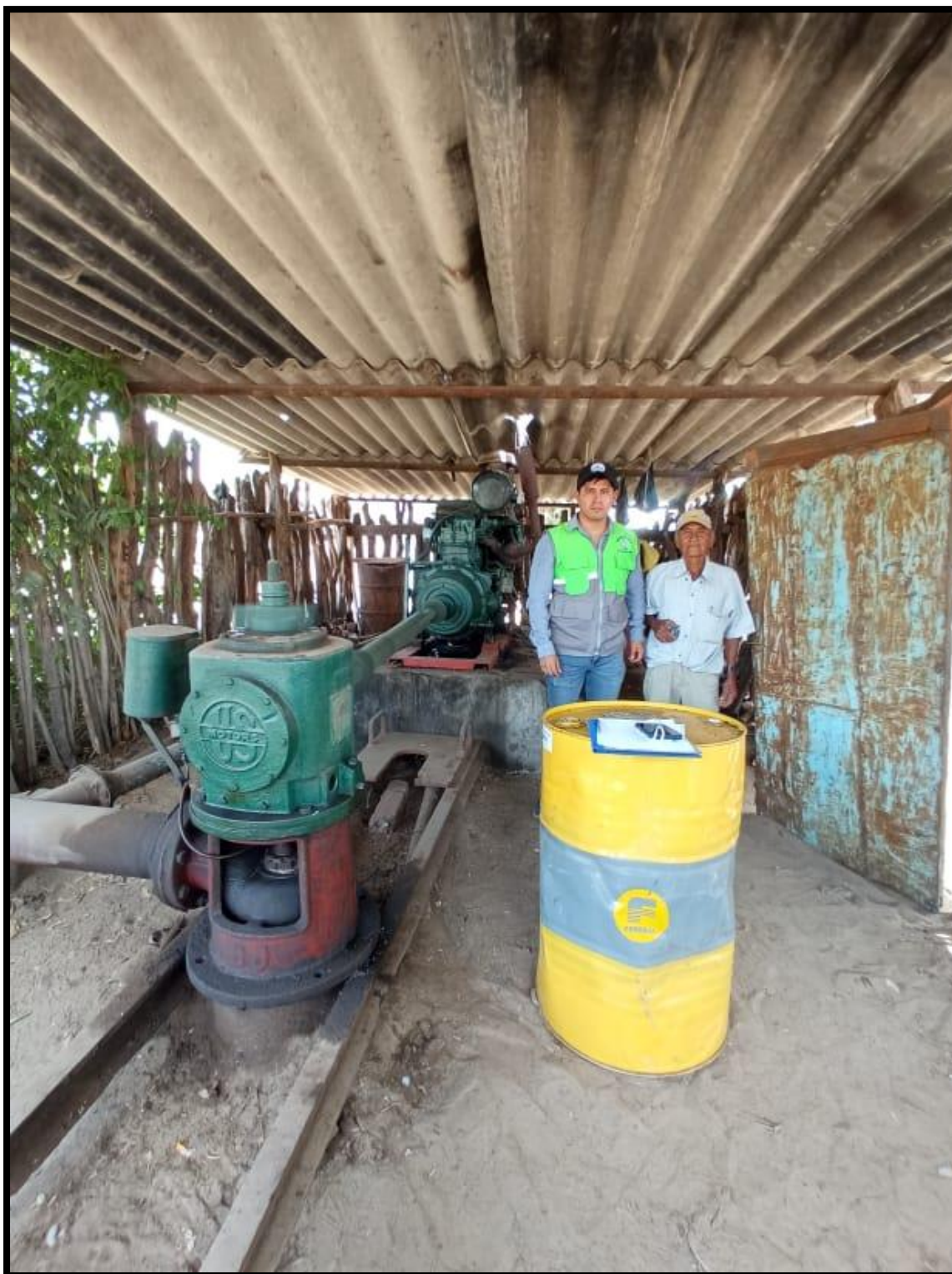
Imagen 7. José Pedro Castillo Ramos, controlador y monitoreo del funcionamiento del motor.
