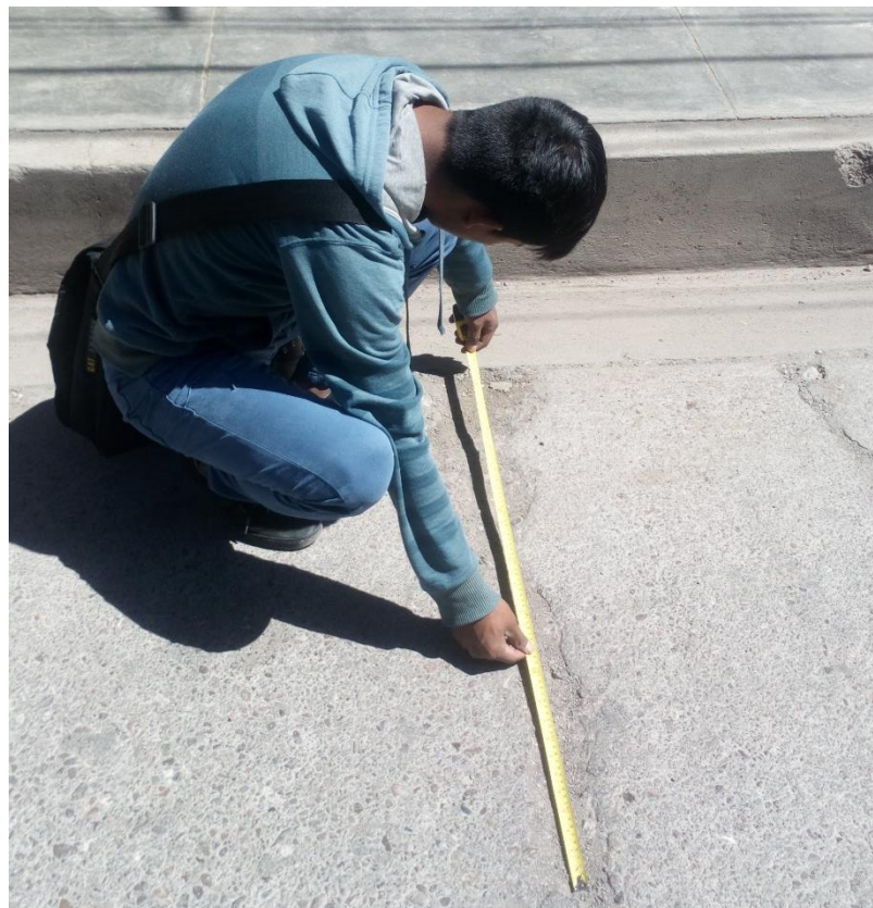
Imagen 12 Grietas de esquina, José Carlos Mariátegui
