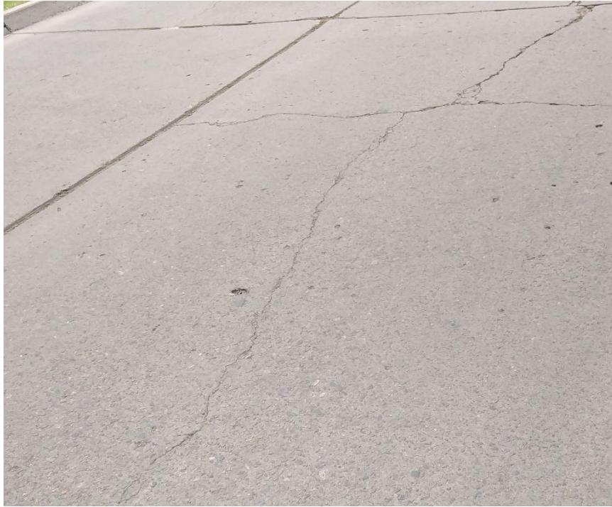
Imagen 13 Grietas longitudinales, transversales, José Carlos Mariátegui
