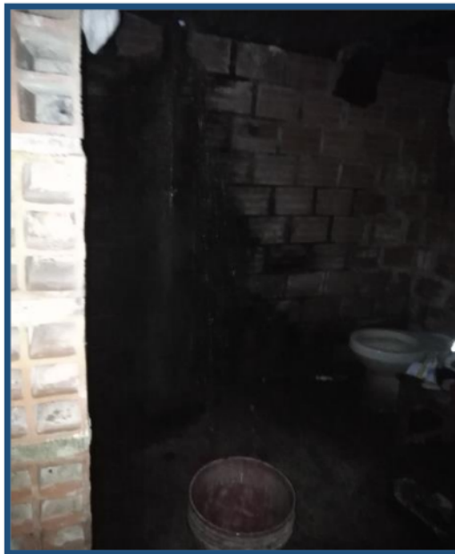
IMAGEN 4: Ducha existente en malas condiciones.
