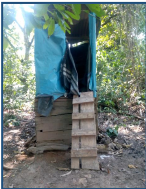
IMAGEN 7: Estado de letrina existente.
