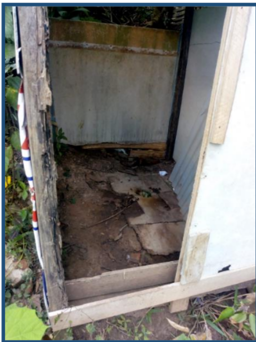
IMAGEN 6: Condición en el que se encuentra el baño.
