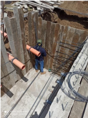
Ausencia del uso obligatorio de Protección de la cabeza (casco) (RUAN, 2022)
