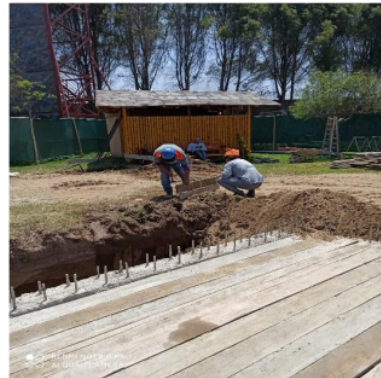
Ausencia del uso de guantes
