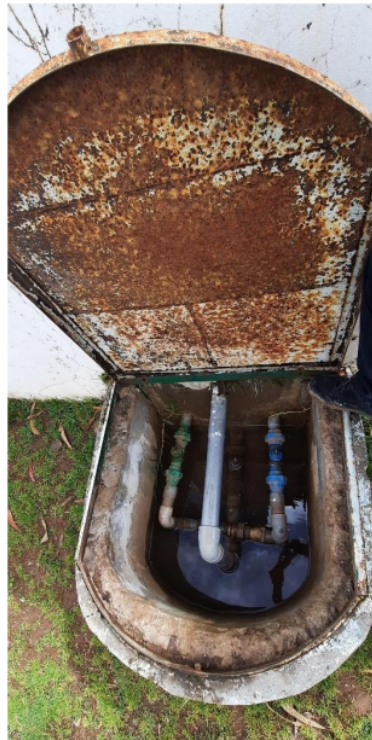
Fotografía 8. Caja de válvulas
