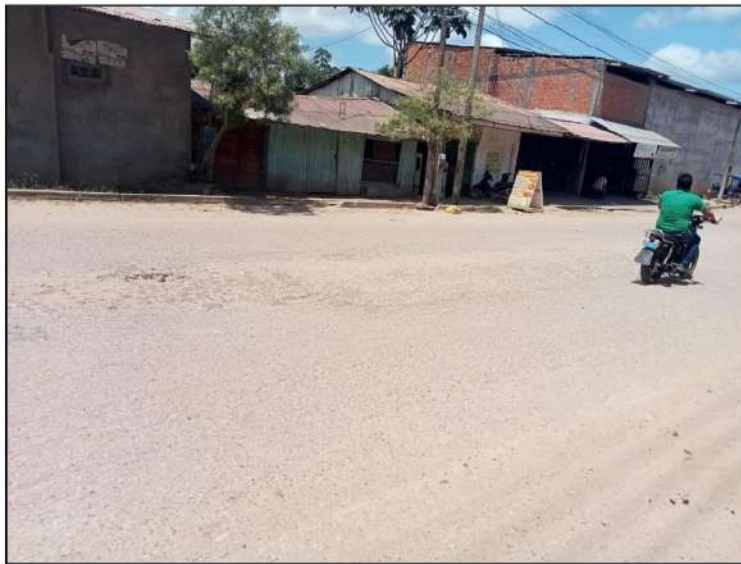
Fotografía N° 02. Uso del PCI para determinar las patologías de la avenida Salvador Allende.
