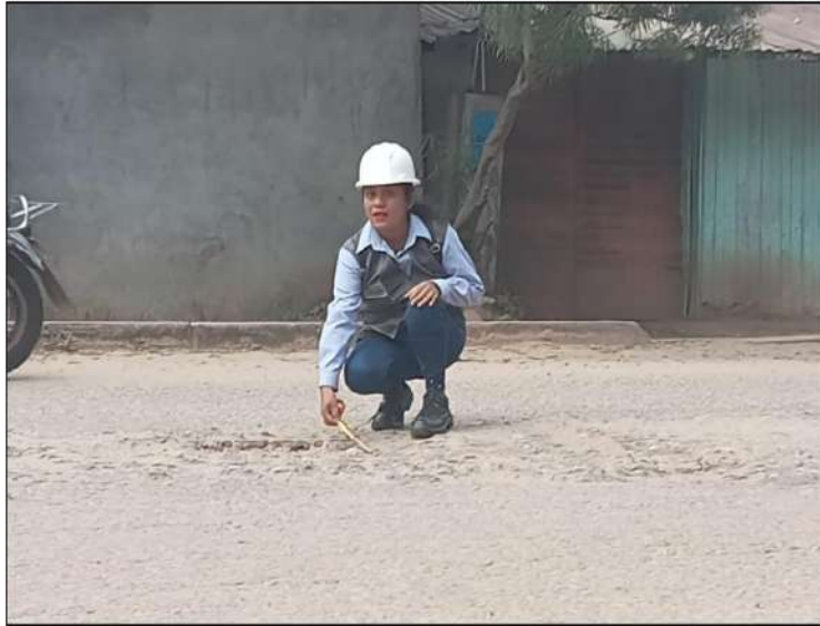
Fotografía N° 01. Uso PCI “Índice de Condición de Pavimento” para definir las patologías de la Av. Salvador Allende.
