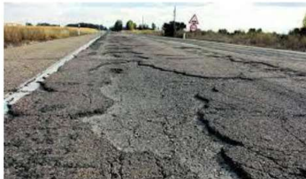
Carretera española en mal estado
