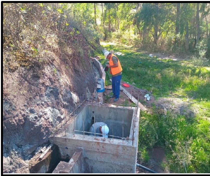
FOTO N° 05 TOMA DE LECTURA DEL AFORO CAPTACIÓN.
