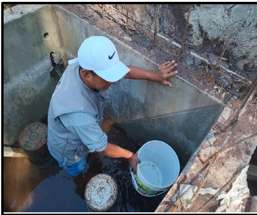
FOTO N° 04 SE OBSERVA LA CAPTACION EN MAL ESTADO
