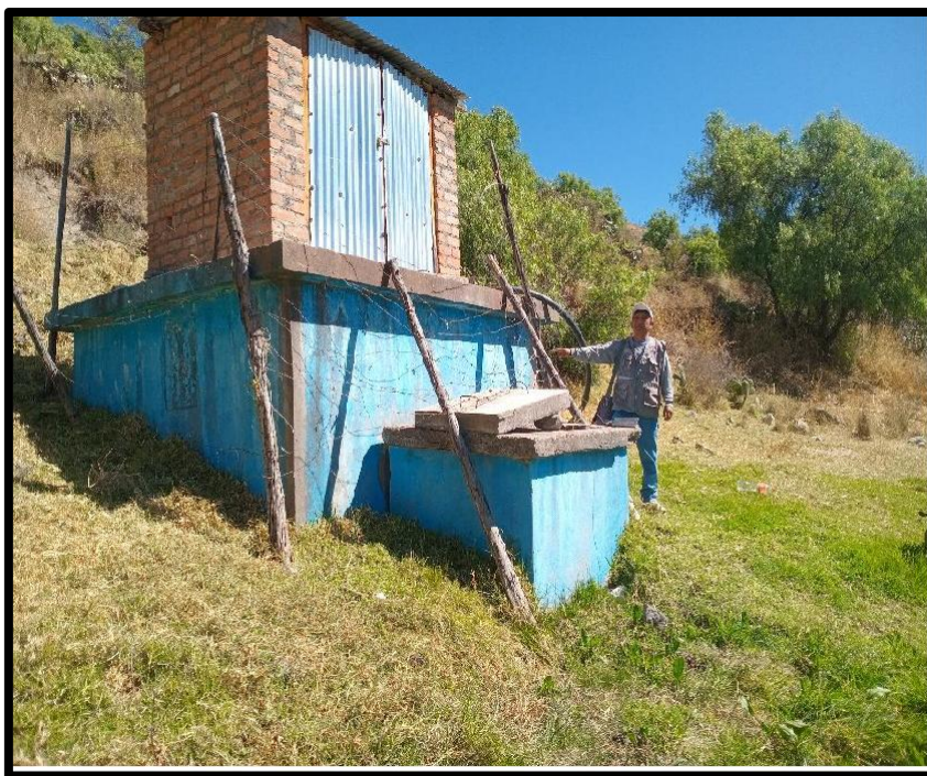
FOTO N° 09 RESERVORIO EN MAL ESTADO SIN CERCO PERIMETRICO.
