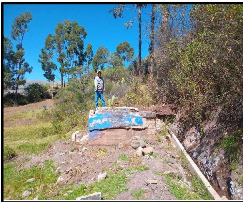
FOTO N° 08 COMPONENTES DEL SISTEMA DE AGUA EN MAL ESTADO.
