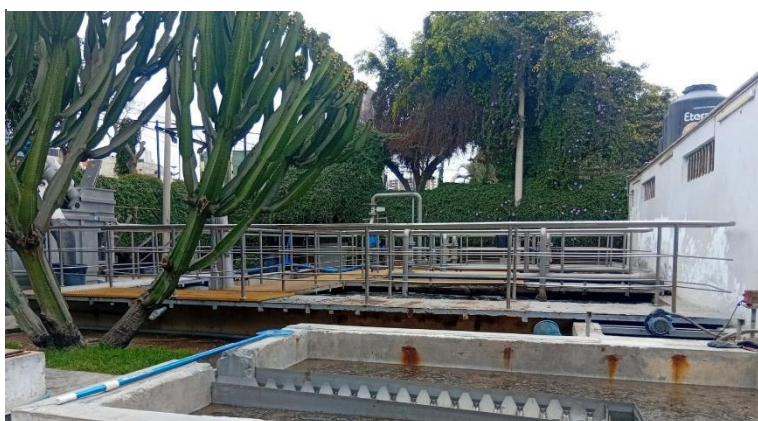
Figura 9. Vista de la Planta de Tratamiento
