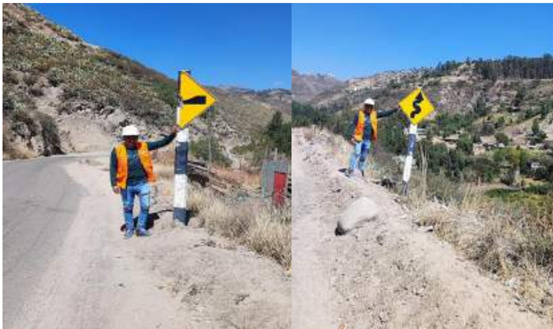
Figura 28. Condición de las Señales Verticales
