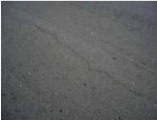
Figura 8. Grietas Longitudinales y Transversales
