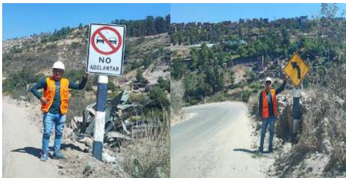
Figura 29. Condición de las Señales Verticales
