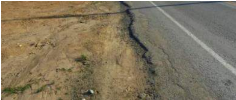
Figura 7. grietas de borde
