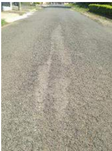
Figura 16. Peladura por Intemperismo y Desprendimiento de Agregados
