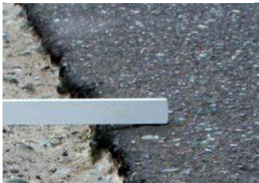
Figura 14. Desnivel Carril- Berma
